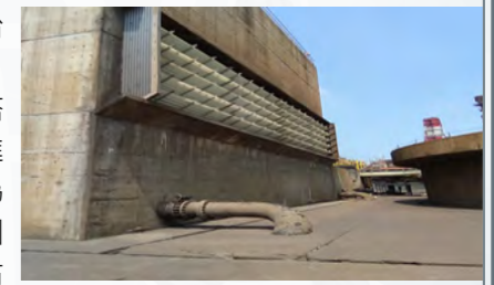
高爐洗塵水冷卻水塔改善
